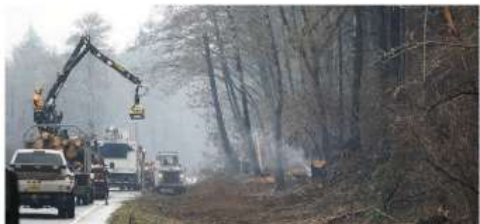
В ходе расчистки пожароопасного участка в OR18 сохраняется задымление (Источник: ODOT)
