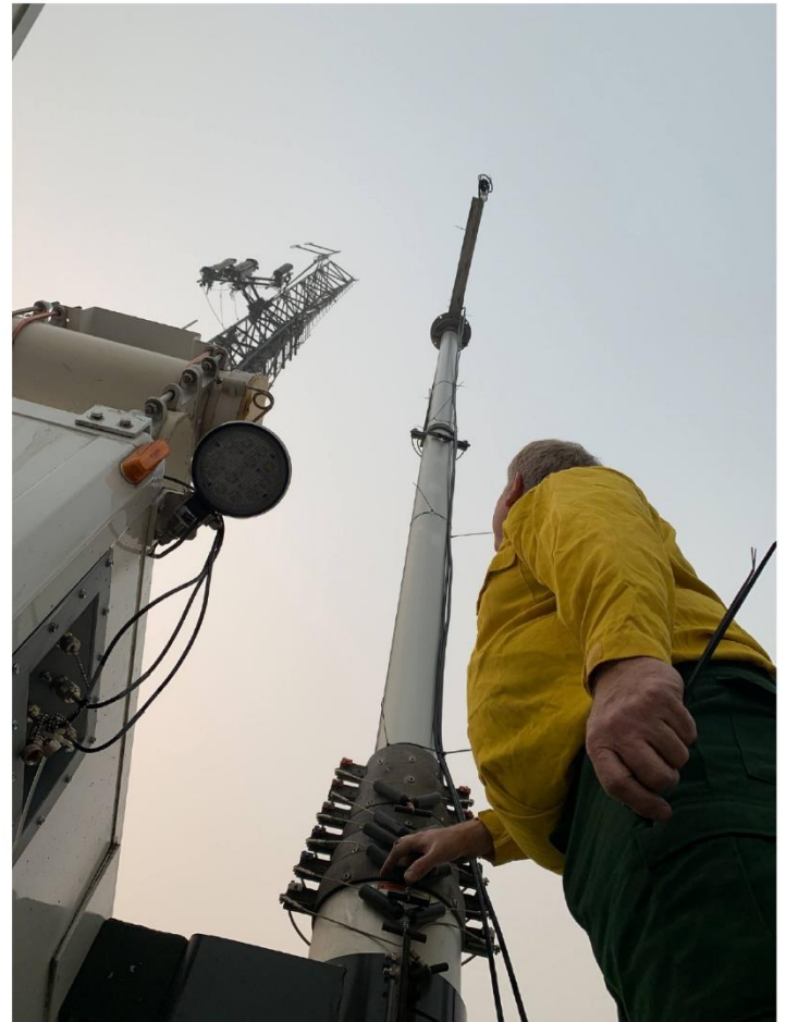
Torre inalámbrica móvil. Lane County, Ore. 16 de septiembre de 2020
